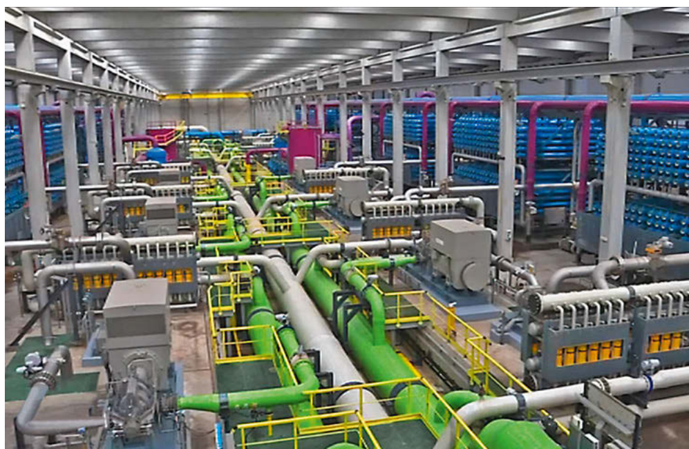
Installations d'une usine de dessalement d'eau de mer située à Barcelone, Espagne.
