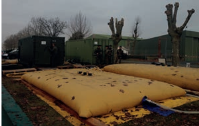
Les Stations de Traitement d'Eau Potable (STEP) sont utilisées par l'armée de l'Air. (© F. Galland)
